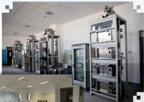
智能电梯安装调试 维护训练场所
